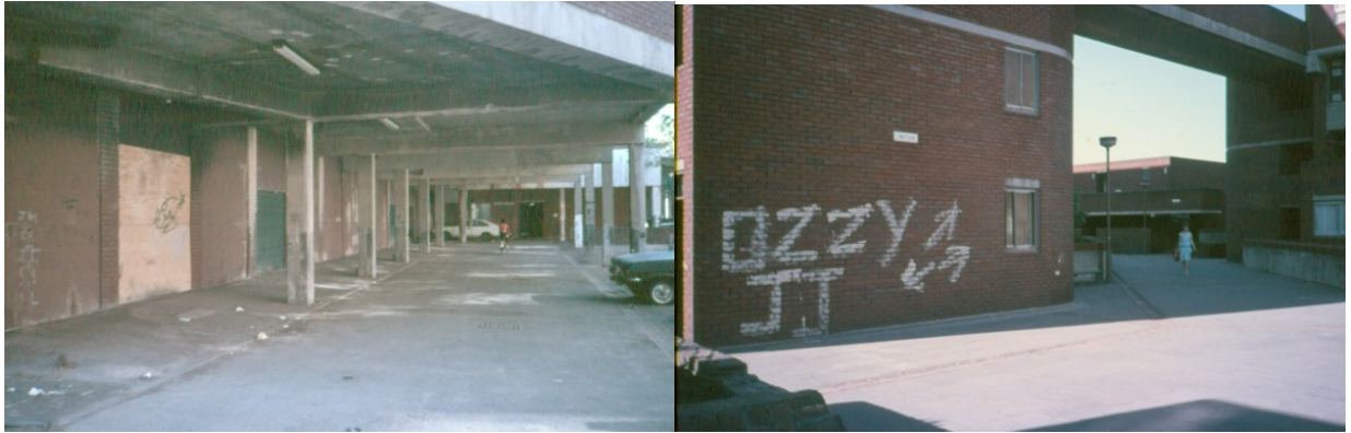
شكل 7 - اعمال تخريب وتشويه للحوائط فوق المنصة وفي مواقف السيارات تحت النصة داخل مجمع سكني في مدينة لندن
