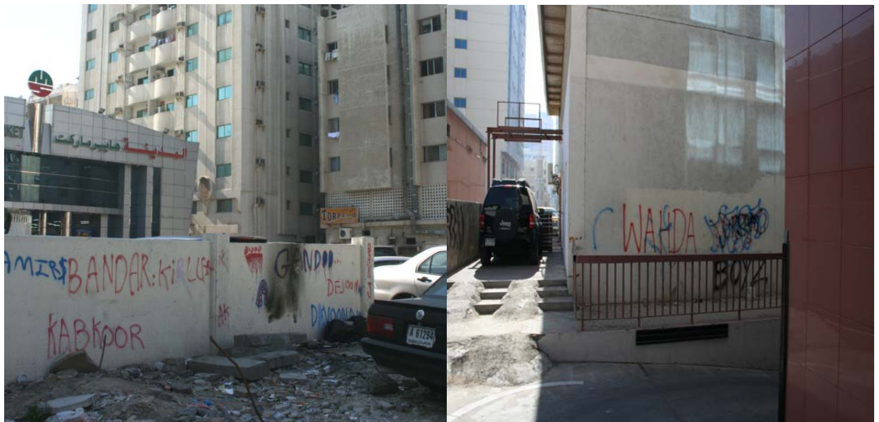
شكل 11- منطقة سكن شققي عالي قديمة نسبياً حيث تتركز فيها مشكلة التصرفات اللا اجتماعية و تبدو على انها تمر كذلك بمشكلة الحلقة المفرغة اذ تتميز المنطقة بانخفاض قيمة الايجارات وإهمال واضح في الصيانة
